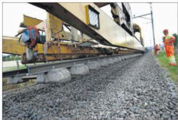
Le tronçon entre Delémont et Courtételle pourrait être aménagé de traverses plates à accueillir un troisième rail. En parallèle, le projet de troisième rail fait l'objet de plusieurs études cette année.
